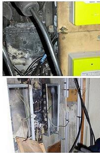
photo Linky dans une cage d'escalier à la Pierre Heuzé à Caen
